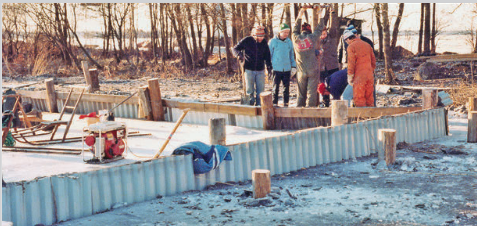
HAMNBASSÄNGEN skonades först med plåtspont. Efter 15 år var den rostangripen och byttes mot träspont.
